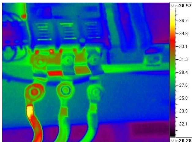
Рисунок 21. Пример термограммы контактных соединений с температурной шкалой
