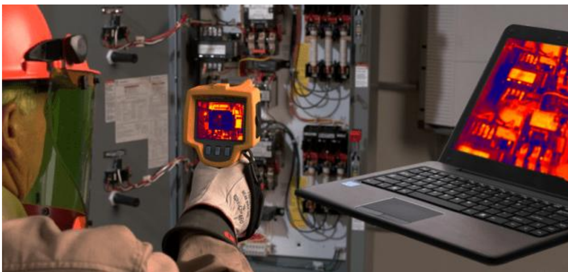
Рисунок 20. Пример проведения тепловизионного контроля электрошкафа
